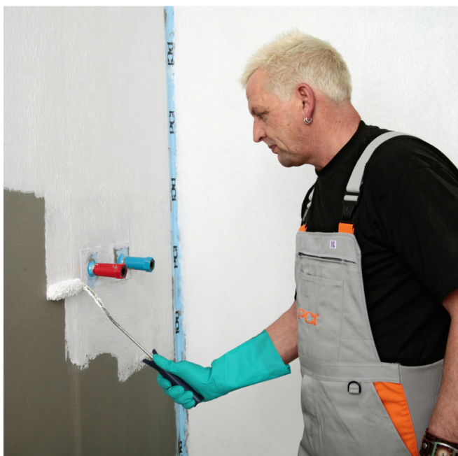
5. Druhá vrstva izolace PCI Lastogum® (bílá, zvolena druhá barva, aby bylo zřetelně vidět překrytí jednotlivých od sebe barevně se lišících vrstev) se nanese po cca 1 hodině odvětrání. První vrstva nesmí prosvítat, v případě potřeby se opakovaně přetře.
